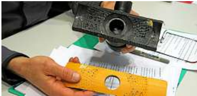
Nur bei Zerstörungsprüfung sichtbar: unsachgemäße Klebeverbindung Gasleitung (gelb) und Muffe. Foto: Frank Döbert
