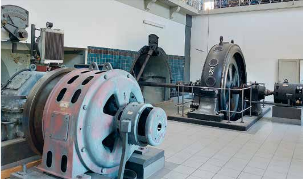
Blick ins Turbinenhaus im Unteren Werk in Kolbermoor
